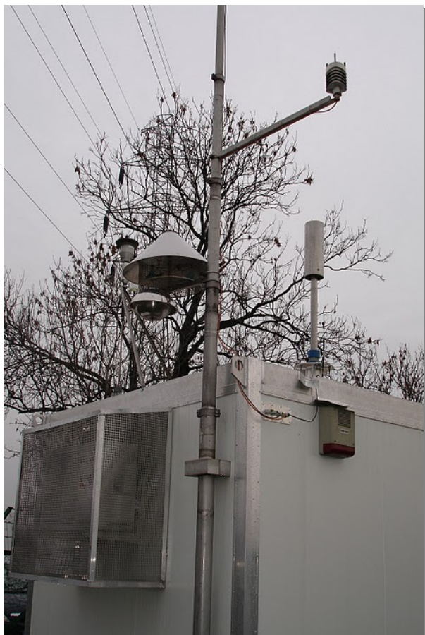
Klimatyzator, maszt meteorologiczny ze stacją pogodową
