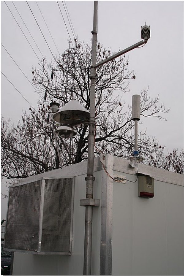
Klimatyzator, maszt meteorologiczny ze stacją pogodową
